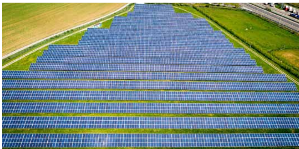
Sonnedix Novi Ligure Solar, Solcellsanläggning.
